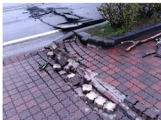
写真8-4：道路の亀裂及び段差
