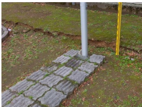
写真 8 - 10 : 地面のひび割れ及び段差
