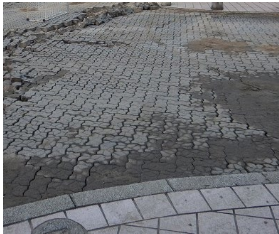
写真 8 - 12 : 道路の亀裂及び液状化
