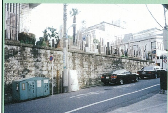
地震時は上から墓石が落ちてくる！？
