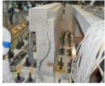
衝突後の擁壁の状況
