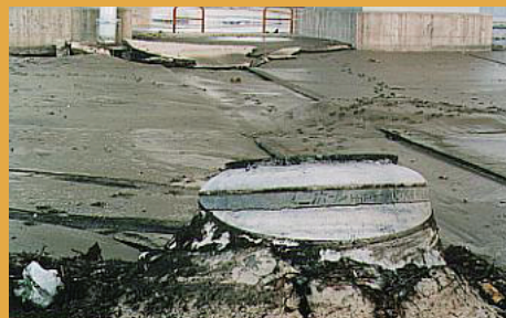
液状化によるマンホールの浮上(兵庫県南部地震) (埼玉大学提供)
