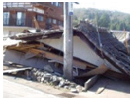
木造住宅の倒壊(平成19年(2007年)新潟県中越地震) (新潟県提供)
