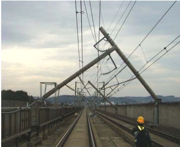
【電化柱の折損】 本震約540箇所、余震270箇所
