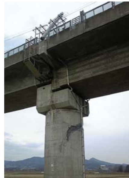
【橋りょうの橋脚の損傷】 一ノ関～水沢江刺
