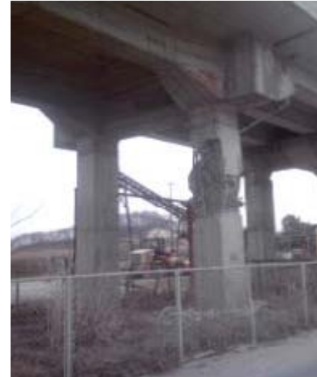
【高架橋柱の損傷】 本震約100箇所、余震20箇所
