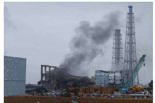
東京電力(株)福島第一原子力発電所3号機 (東京電力HP(3月21日撮影)より)
