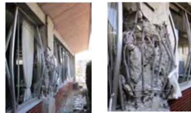
市役所本庁舎の被災状況
