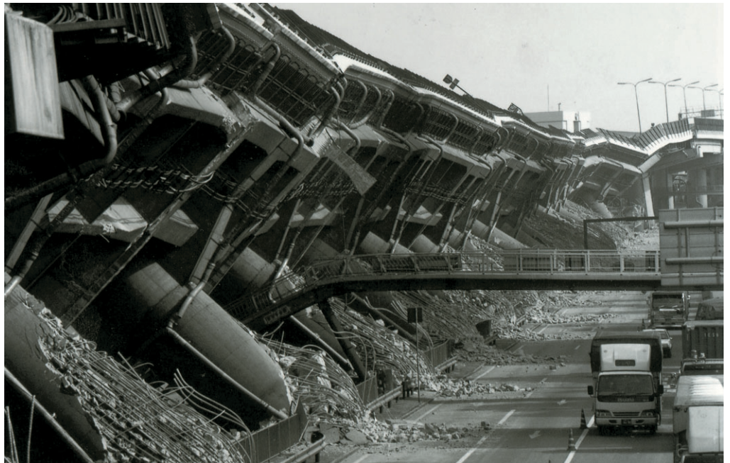
平成7年兵庫県南部地震により倒壊した阪神高速神戸線。
