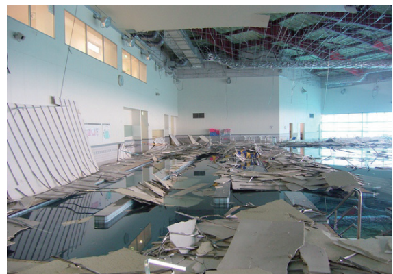
図4-43 2005年の宮城県沖の地震による建物の被害(宮城県仙台市) [気象庁(2005)による] 屋内プールの天井パネルのほぼ全体が落下し、負傷者が出た。
