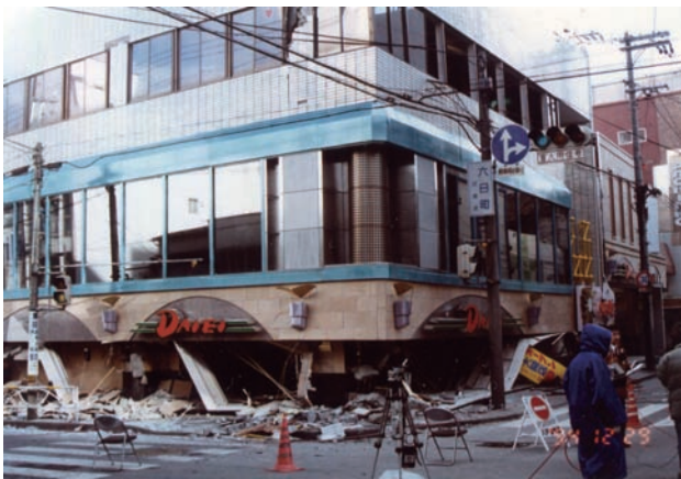
図4-32 「平成6年(1994年)三陸はるか沖地震」による建物被害 [八戸消防署撮影]
