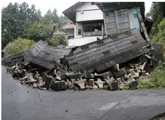
図4-39 2003年の宮城県北部の地震による家屋の倒壊(宮城県河南町(旧名、現在の石巻市)) [国土地理院ホームページによる]
