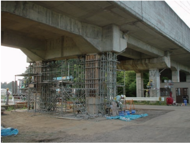
図4-35 2003年の宮城県沖の地震による新幹線の橋脚の被害(岩手県石鳥谷町(旧名、現在の花巻市)) [国土地理院ホームページによる] 東北新幹線の橋脚のコンクリートの剥落部分を補強している。
