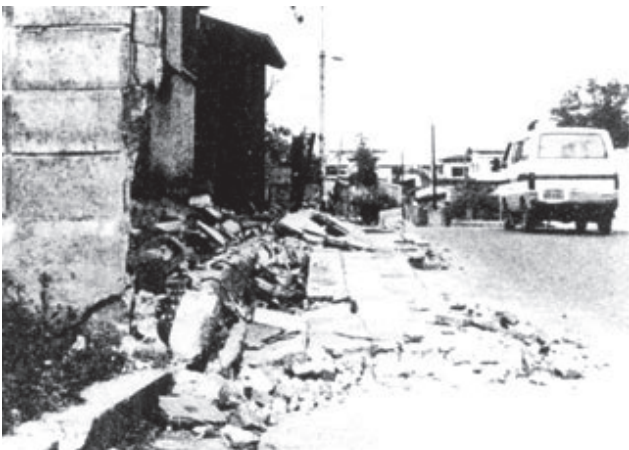
図4-23 「1978年宮城県沖地震」によるブロック塀の崩壊 [基礎地盤コンサルタンツ(株) 提供]
