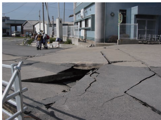
図9-18 2005年福岡県西方沖の地震で生じた岸壁の亀裂、陥没(福岡市玄界島) [気象庁(2005)より]
