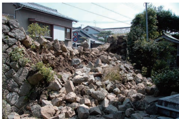
図7-26 紀伊半島南東沖の地震による石垣の倒壊(和歌山県新宮市) [気象庁(2004)より]
