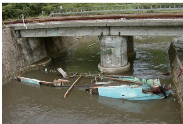
図7-25 紀伊半島南東沖の地震における津波により破壊された船(三重県尾鷲市) [気象庁(2004)より]
