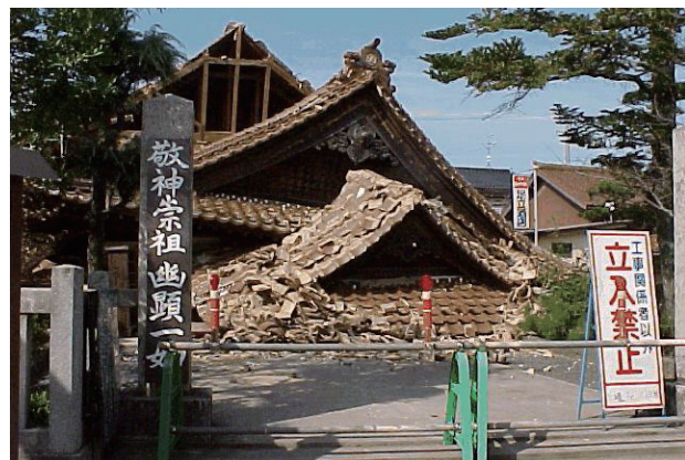
図8-18 「平成12年(2000年)鳥取県西部地震」で倒壊した出雲大社上道教会(鳥取県境港市)
