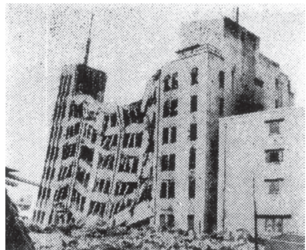
図6-18 福井地震の被害写真(ビルの倒壊) [片山成一氏撮影]
