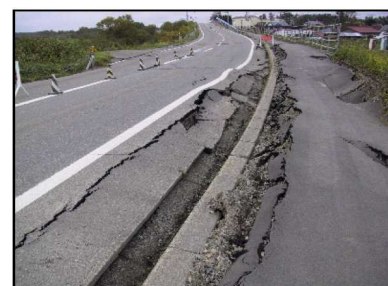
2003年十勝沖地震により亀裂や陥没が発生した道路(気象庁提供)
